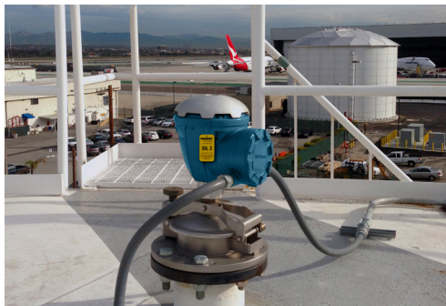
Рис. 2.10. Современный радарный уровнемер для резервуара с неподвижной крышей
