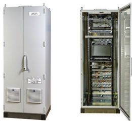
Рис. 9.5. Шкаф системы измерения учета в резервуарах.
