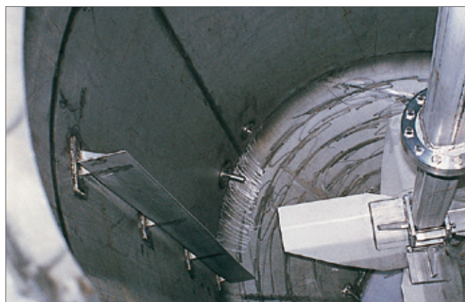
Valvola per campionamento cisterne Interno della vasca
