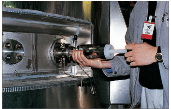
Tank Probenahmeventil Probenahme mit einer 250 ml Kolbenspritze
