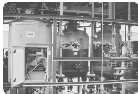
Steuerung von fremdbetätigten Ventilen in einer Batterie-Recyclinganlage
